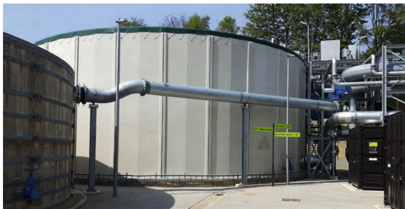
8 Tank WBL in bedrijf
